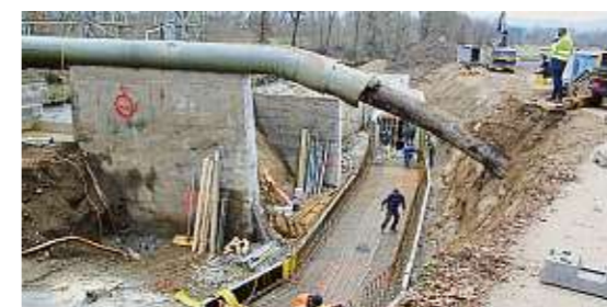
Die Fischaufstiegshilfe bei der Fischeringer Wehr ist ein großes Projekt. 3,15 Höhenmeter müssen überwunden werden
